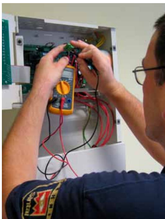
Pregled protipožarnega sistema mora izvesti strokovno usposobljena oseba.
